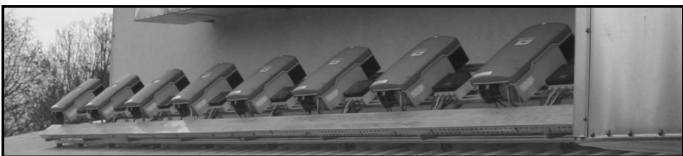
Wechselrichter auf der Rückseite des Daches
